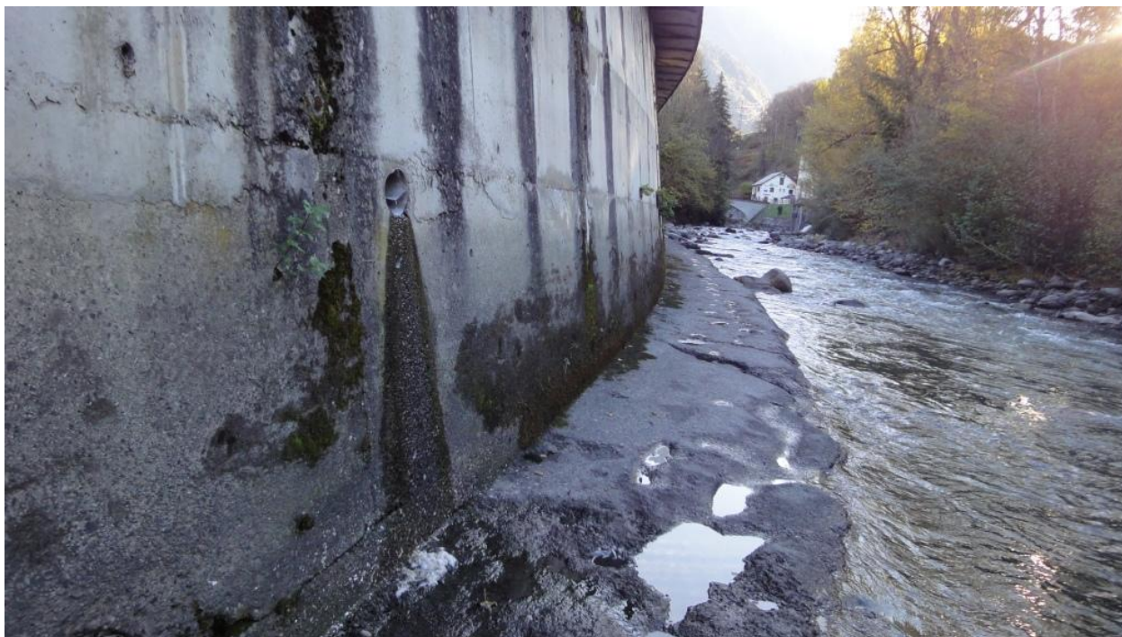
Figure 2 : rejets en rive droite de la Neste
